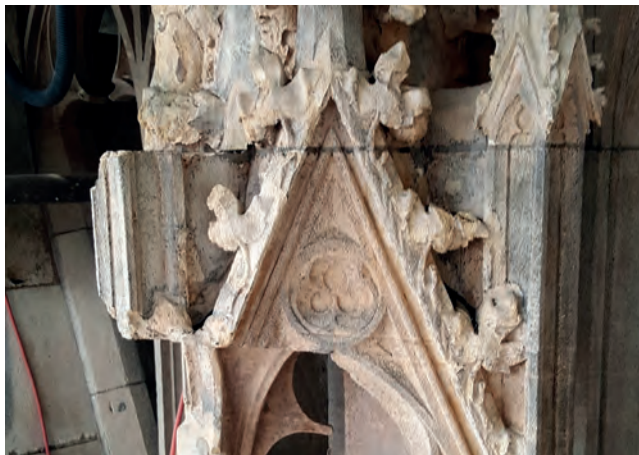
Deutlich sichtbare Verwitterungen am Stephansdom in Wien (Fotos: Archiv der Dombauhütte St. Stephan)
