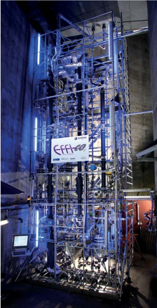
Das Science-to-Business-Center Eco 2 der Creavis: Die neu entwickelten Absorbenzien für das vom BMBF geförderte Projekt „Efficio2 – Neue Absorbenzien zur effizienteren CO 2 -Abtrennung“ getestet unter realen Bedingungen eine neun Meter hohe Versuchsanlage eines Heizkraftwerks. Um den Prozess optimal verfolgen zu können, besteht die Anlage aus Glas.
